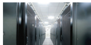
データセンター内部の写真
