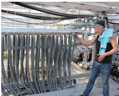
温水・冷水を地中に循環させるための設備
